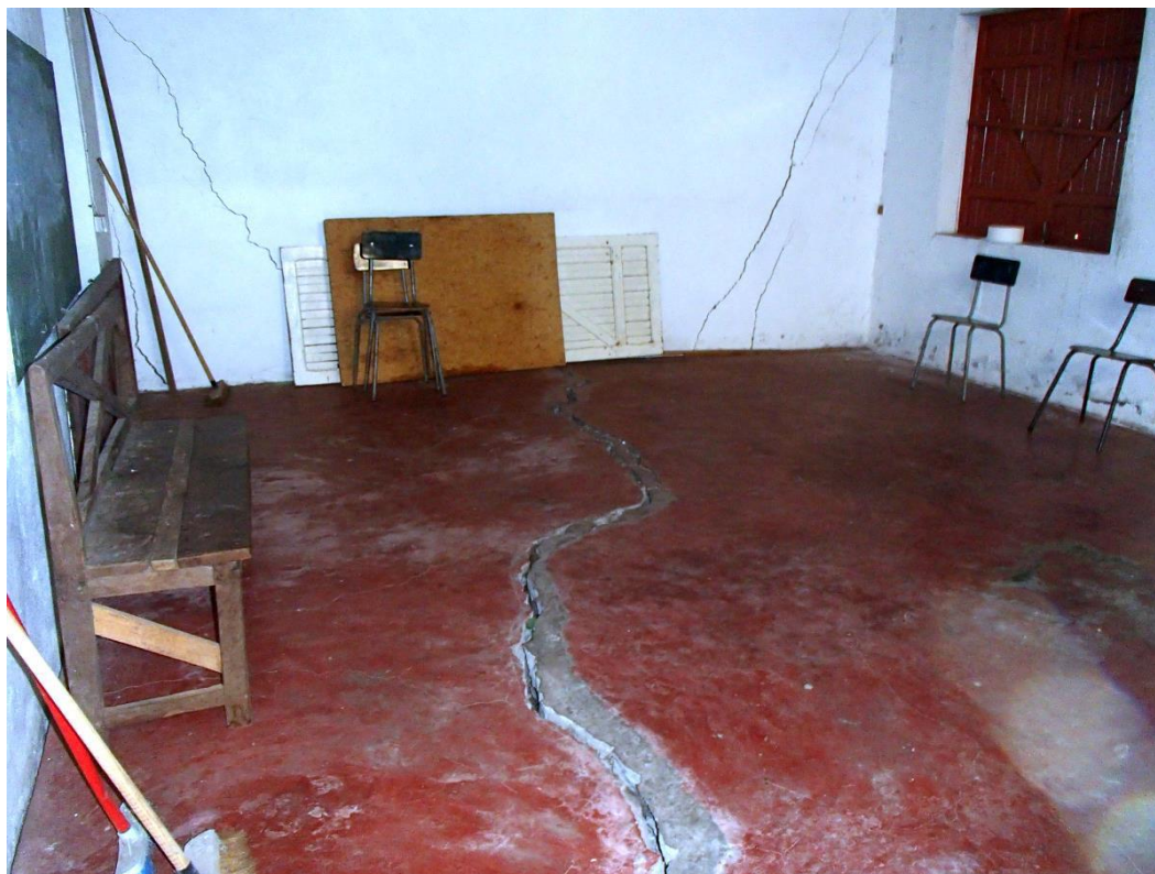
Figure 16 : Exemple de désordre dans le bâti causé par les glissements de terrain de grande ampleur
