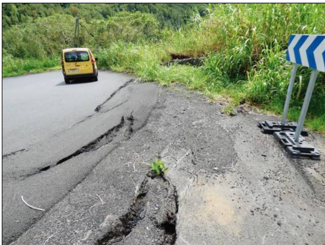
Figure 34 : Déformation de la RD48 dans le secteur de Hell-Bourg (Mars 2018)
