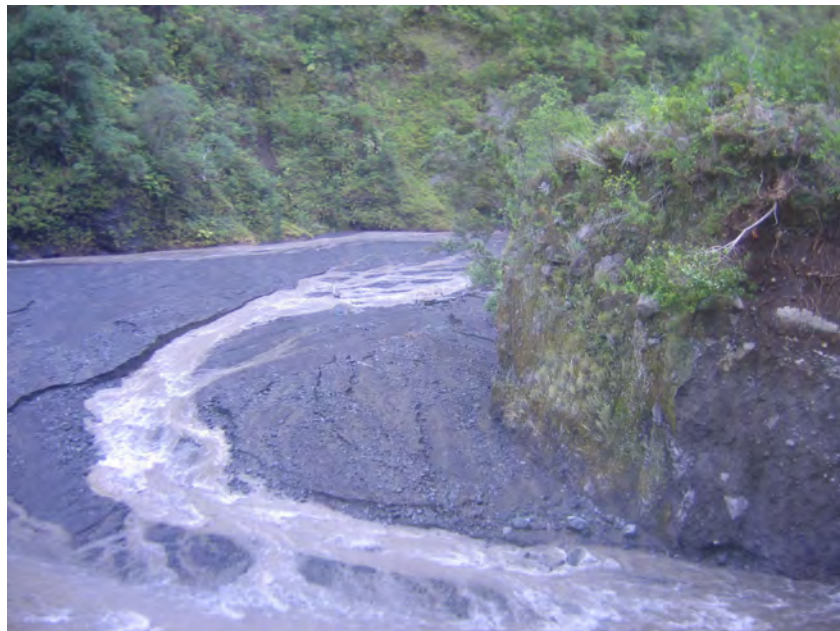
Photo n°65 – CRUE DE FEVRIER 2006 – DEPOT DE MATERIAUX FINS EN AMONT DE LA PLATEFORME (TALUS SUD) (24 FEVRIER 2006)
