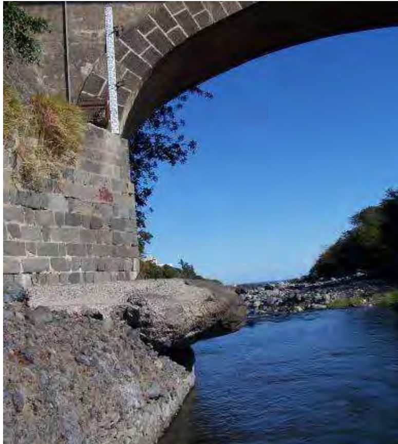
Photo n° 14 – DEBUT D'AFFOUILLEMENT A LA BASE DU PILIER RIVE GAUCHE DU PONT DOMENJOD
