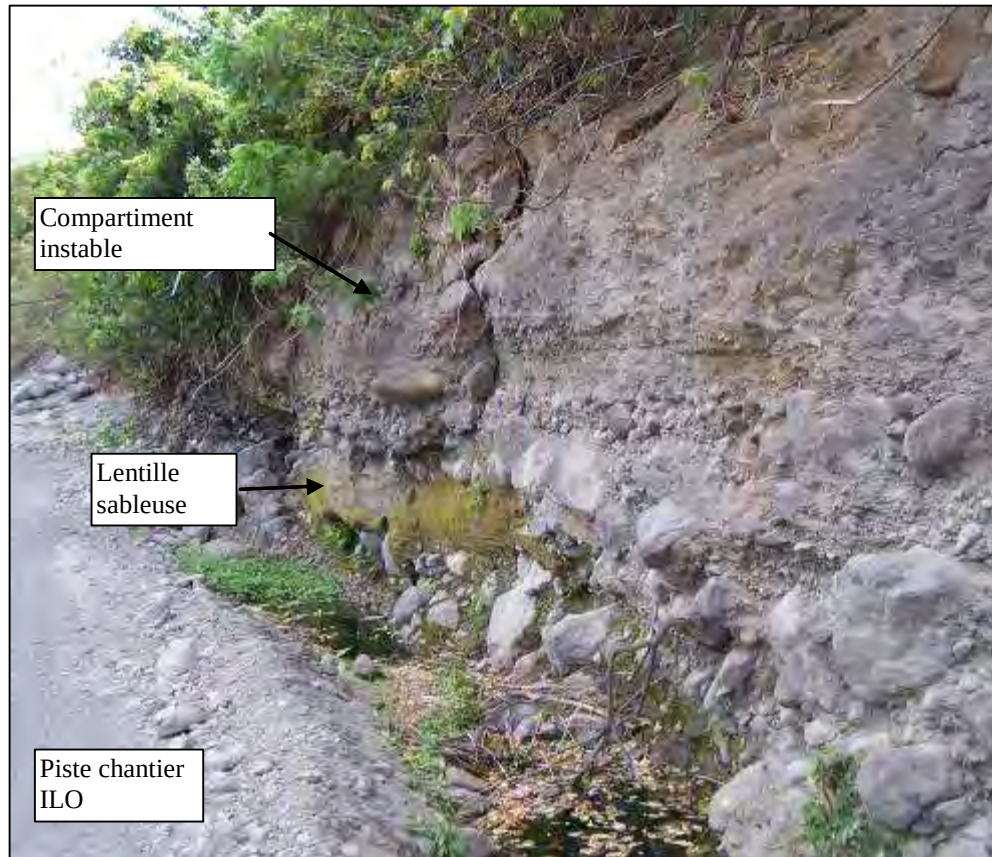
Photo n°15 – SOUS-CAVAGE DANS DES DEPOTS D'ALLUVIONS ANCIENNES HETEROGENES
