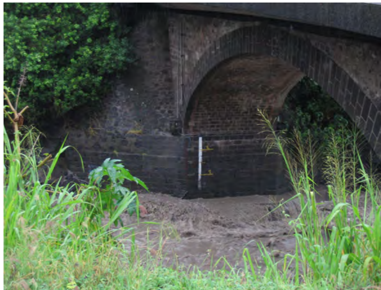
Photo n°44 – CRUE DE FEVRIER 2006 – PONT DE DOMENJOD (18/02/06 A 16H30 – SOGREAH)
