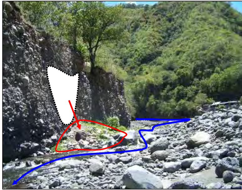
Photo n°17 – SAPEMENT DE LA BASE DE LA TERRASSE ALLUVIALE EN FACE DE LA CONFLUENCE DE LA RAVINE MONTAUBAN
