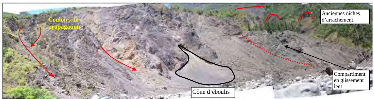
Photo n°59 – EROSION DU FLANC NORD-EST DU RELIEF DU GRAND EBOULIS (CLICHE NOVEMBRE 2007)
