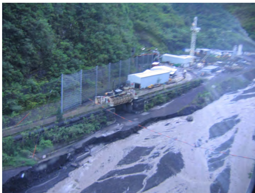
Photo n°62 – CRUE DE FEVRIER 2006 – EROSION DE LA BERGE RIVE DROITE EN PARTIE AVAL DE LA PLATEFORME AU NIVEAU DU BASCULEUR (20 FEVRIER 2006)
