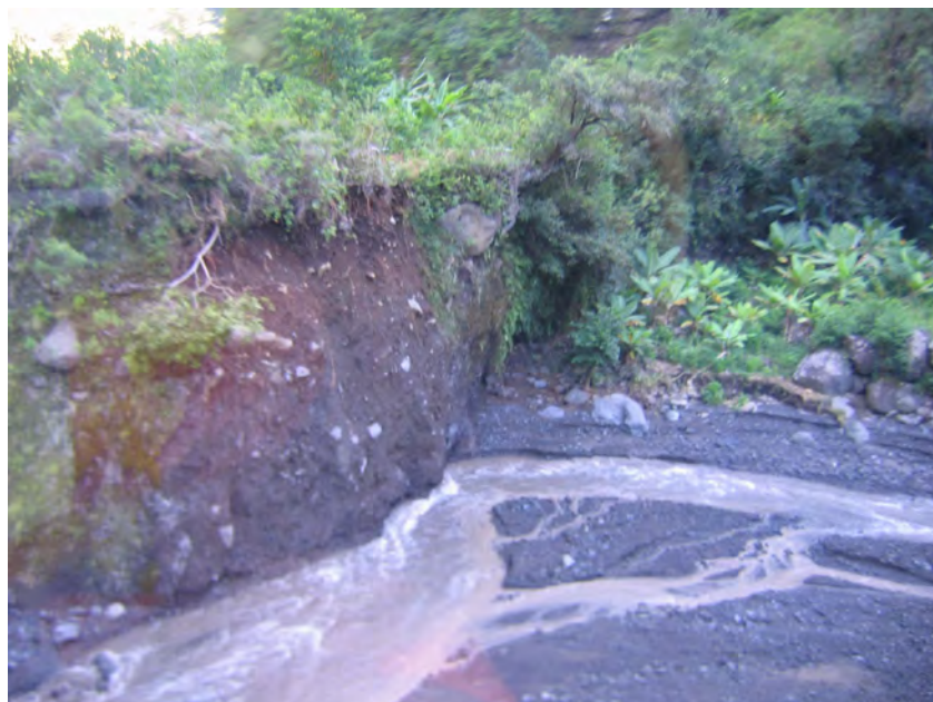
Photo n°61 – CRUE DE FEVRIER 2006 – ATTAQUE DES DEPOTS CIMENTEES DU TALUS SUD DE L'ILET DE LA PLATEFORME (24 FEVRIER 2006)
