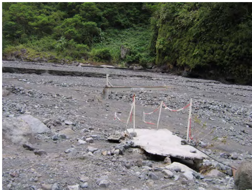
Photo n°66 – CRUE DE FEVRIER 2006 – DEPOT DE MATERIAUX FINS EN PARTIE AMONT DE LA PLATEFORME, AU NIVEAU DE LA "DZ" (25 FEVRIER 2006)
