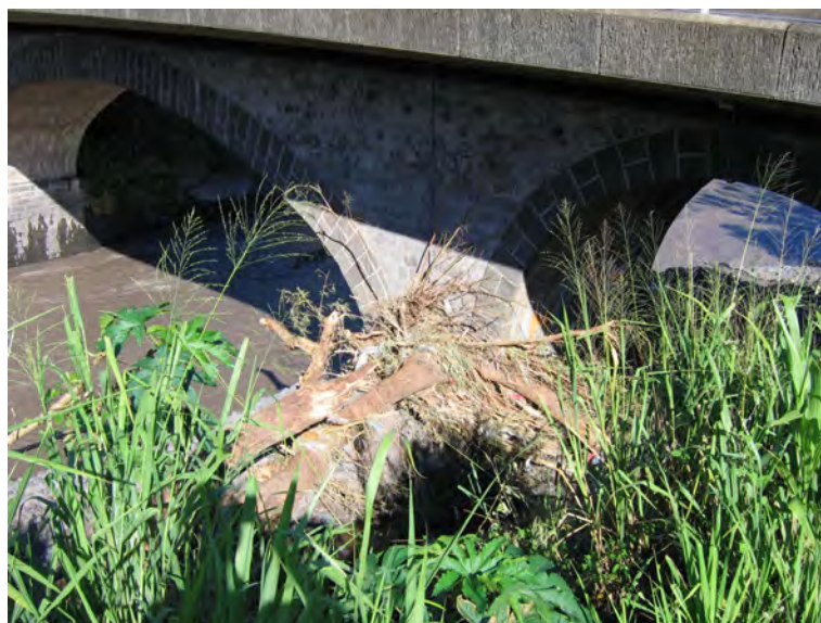
Photo n°45 – CRUE DE FEVRIER 2006 – PONT DE DOMENJOD – LAISSE DE CRUE
