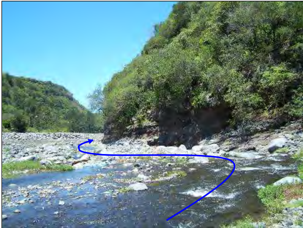
Photo n°2 – BERGE ROCHEUSE SITUEE EN FACE DE L'ILET QUINQUINA AMONT (FORMATION D'UN POINT DUR ET DEVIATION DE L'ECOULEMENT)
