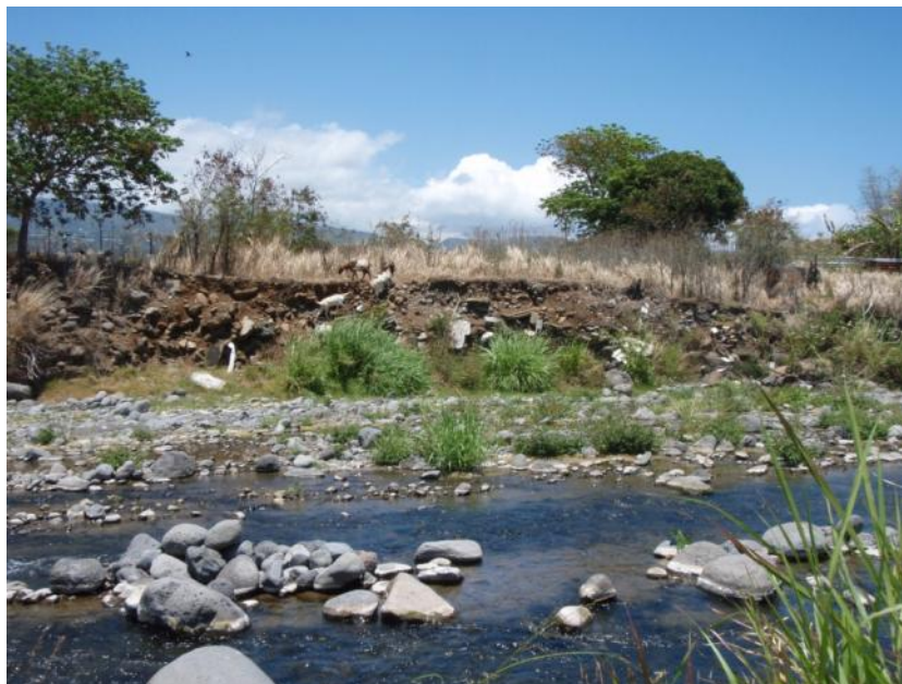
Fig. 12. BERGES ERODEES EN RIVE GAUCHE, A 700 M EN AVAL DU PONT RN2
