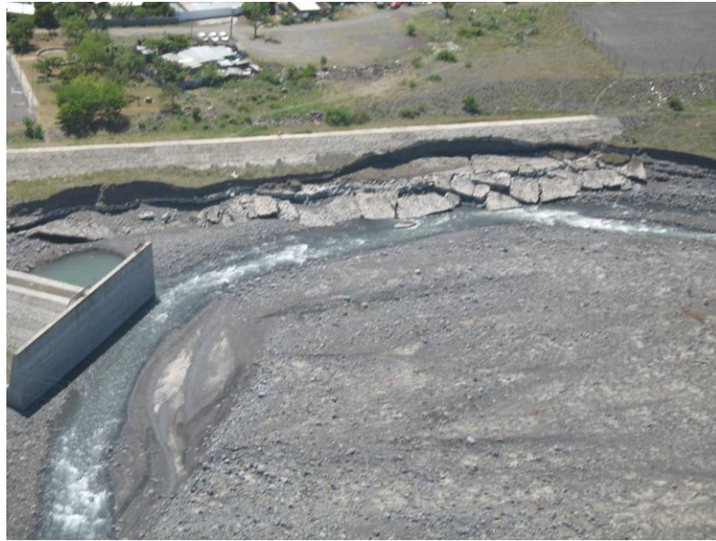
Fig. 56. DOMMAGE SUR UNE DIGUE ENTRE 2 EPIS SUR LA RIVIERE DES GALETS EN 2007
