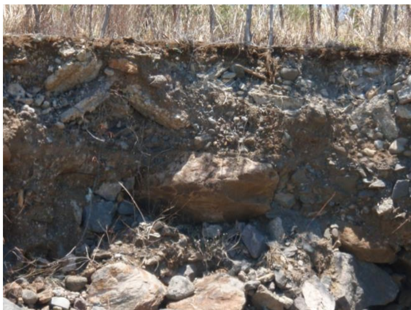
Fig. 13. BERGE ERODEE EN RIVE GAUCHE, A 500 M DE LA COTE (NOTER LA NATURE DES MATERIAUX : BLOCS, GRAVATS, DECHETS FERREUX)
