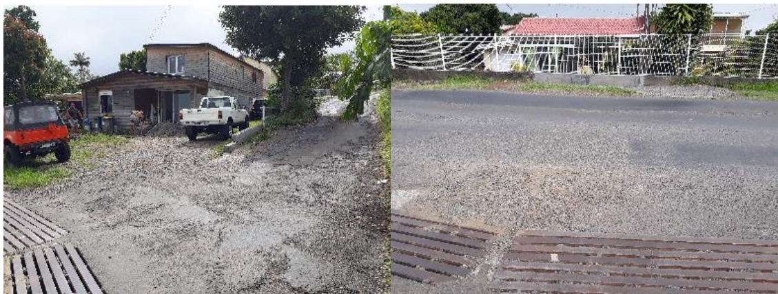
Figure 60 : Sortie de talweg parallèle à la rue M Ravel (à gauche). Muret détruit et reconstruit au droit de la sortie de talweg (à droite)
