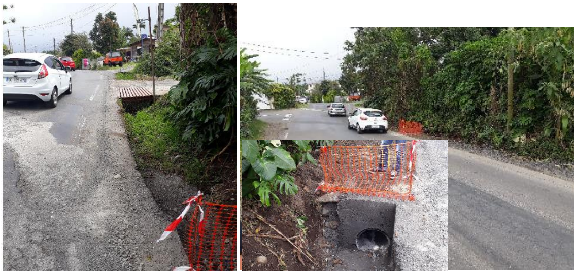
Figure 61 : Réseau pluvial de la RD27 d'abord à ciel ouvert, puis enterré récemment (après Berguitta)
