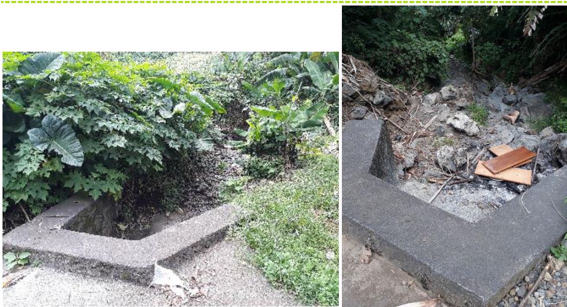
Figure 12 : Vue vers l'amont et l'aval de la ravine 70m en amont du passage à gué sur un franchissement.
