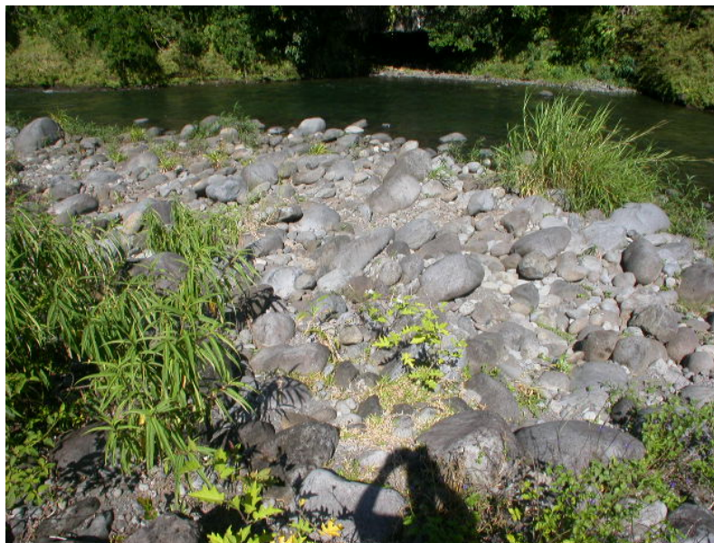
Photo 1 - Atterrissement en amont du pont de la RN2
