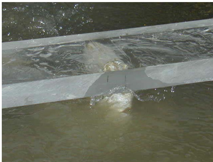
Débordement sur le tablier du pont du centre ville au droit de la pile
