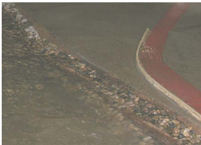
Écoulement au niveau du jardin M. Ferrol
