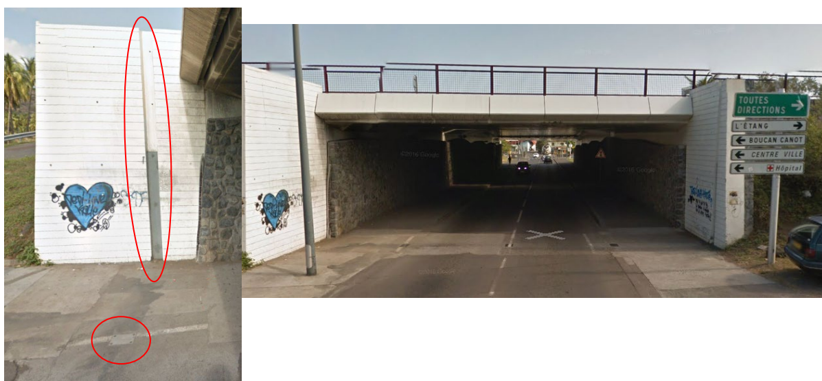
Figure 39 : Pont de la RD5 sous la route-digue de Saint-Paul - rainure et platine pour mise en œuvre d'un batardeau, pour protéger le centre-ville des inondations de l'Étang
