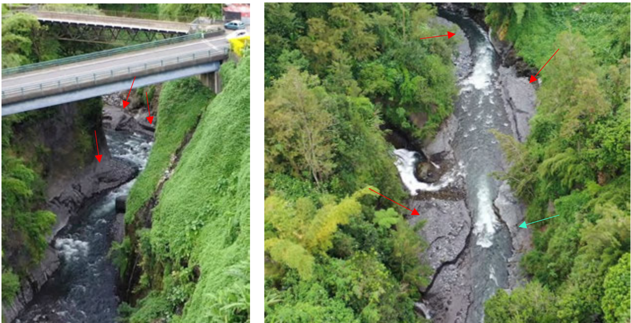
Figure 124 : Terrasses étroites et hautes témoignant d'un exhaussement récent du fond du lit (flèches rouges), chenal s'étant réencaissé entre ses alluvions et affleurement de la roche mère (flèche bleue), tronçon M3 dans la traversée de Salazie
