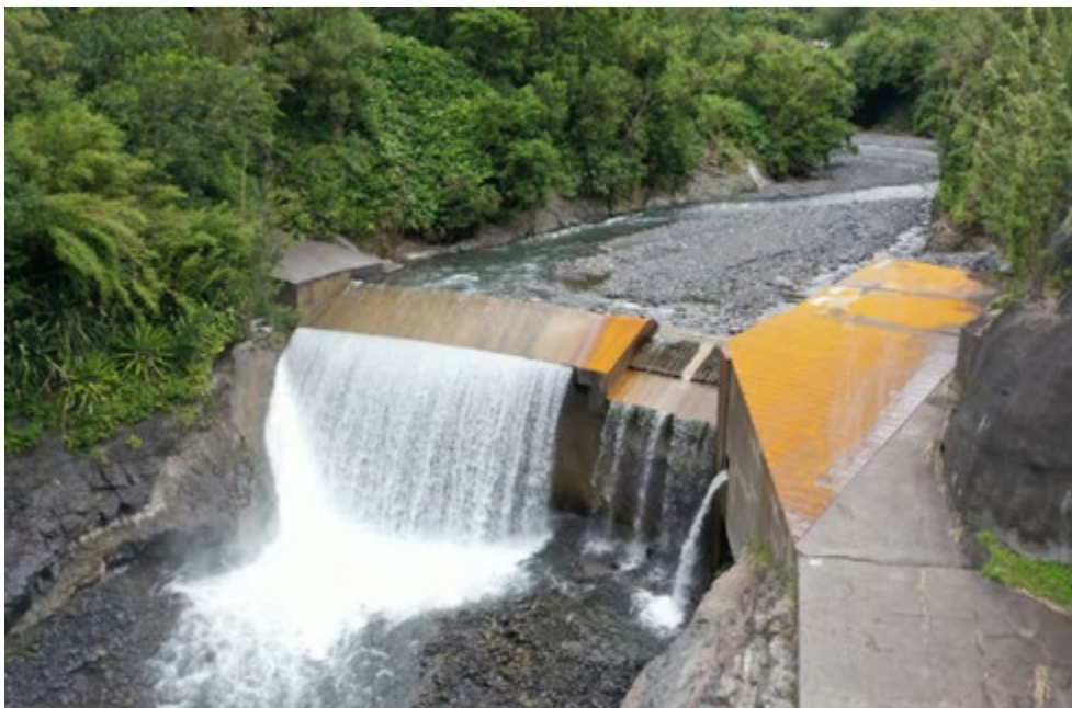
Figure 23 : Prise d'irrigation de la Rivière du Mât
