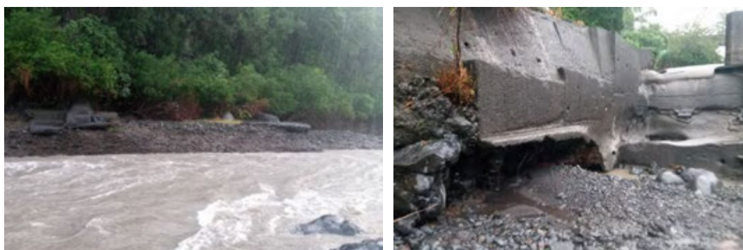
Figure 67 : Signe d'incision de la Rivière du Mât en aval du barrage de Bengalis
