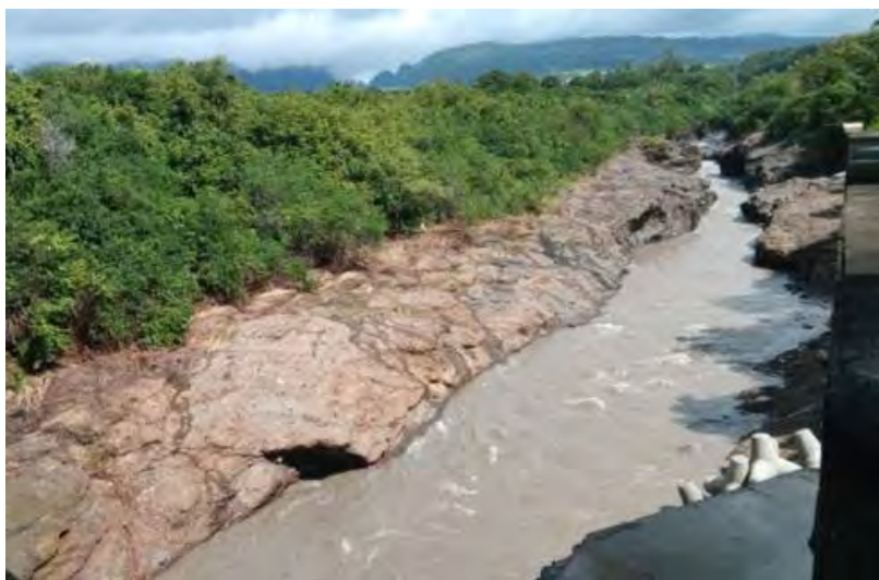
Figure 69 : Formations relativement érodable au droit du pont RN2
