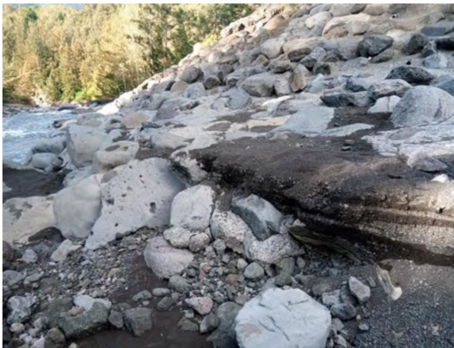
Figure 20 : Affleurement de la semelle de la pile du pont D52, signe d'incision du lit au droit du pont
