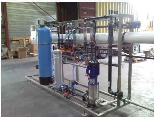
Conception et fabrication d'une unité d'osmose inverse 5m 3 /h – SODEAM
