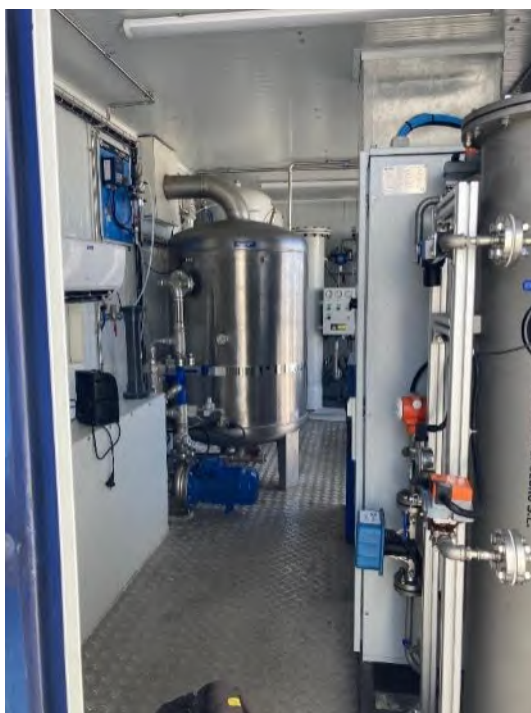
Installation unité d'ozone 500 g/h – CILAM
