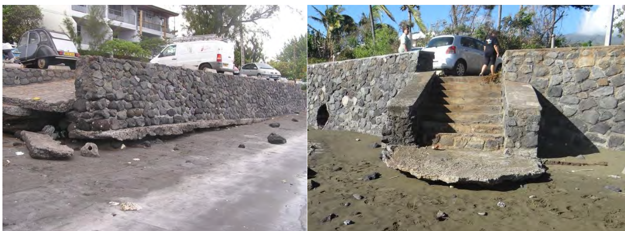
Figure 22 - Déchaussement d'un mur de protection et d'un escalier à l'Étang-Salé-les-Bains (De La Torre et al, 2012)
