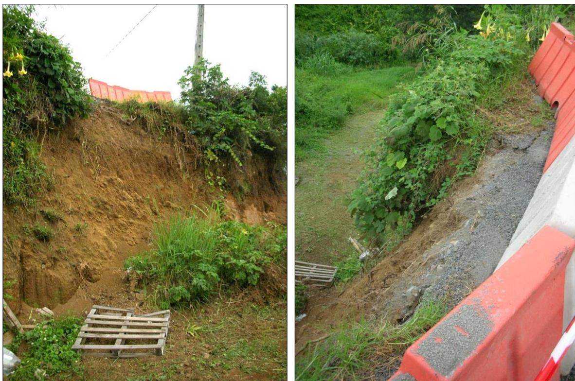
Figure 16 : Glissement de talus sur la RD3 - Janvier 2007 (source : www.georisques.gouv.fr )
