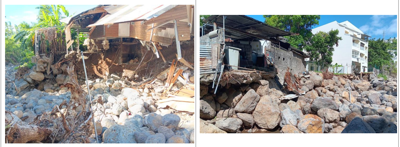
Figure 21 : Exemples de dégâts aux habitations en bord de ravine du Butor, rue Joseph Ouvrier. À gauche, maison fortement sous-cavée et en partie effondrée suite à l'érosion de la berge. À droite, recul de berge en rive droite avec mise à nu des fondations et déstabilisation de plusieurs constructions en pied d'immeuble (photos : CEREMA).
