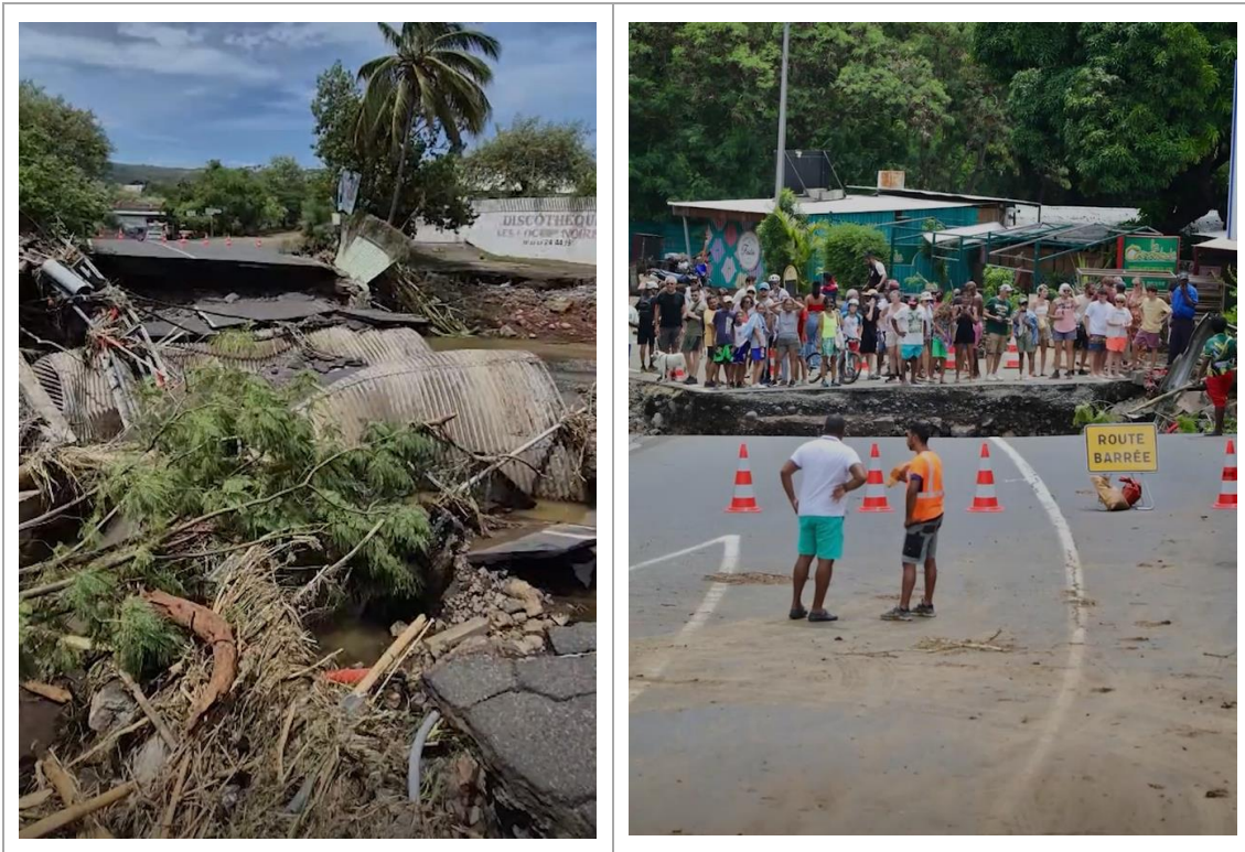
Figure 61 : Photos du pont de la RN2001 détruit
