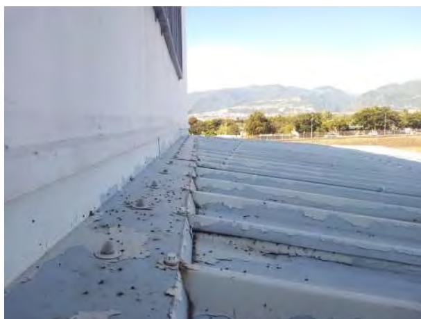
Photo 4: Guano sur le toit au droit de la façade
