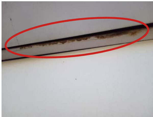
Photo 6: Marquage (suintement) au niveau des évacuations des eaux de pluie
